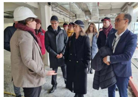
Valérie Drezet-Humez, cheffe de la représentation de la Commission européenne en France, a été reçue à Nancy sur le chantier de l'Institut de recherche et d'innovation en santé (Iris). Photo Thierry Fedrigo
